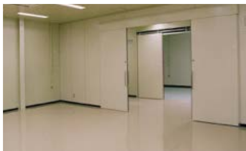
恒温恒湿室・クリーンルーム
